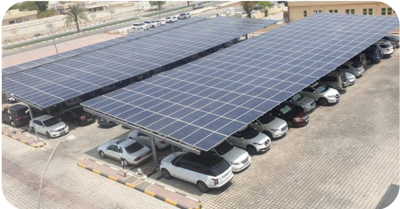
الشكل 31: نظام المواقف الشمسي لبلدية رأس الخيمة
